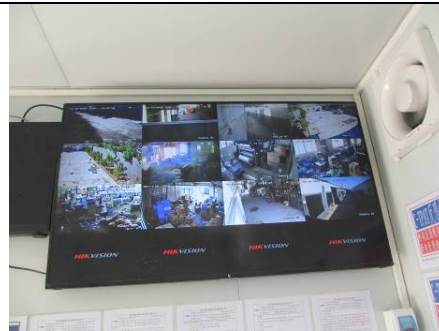
CCTV system at factory 工厂闭路监控系统
